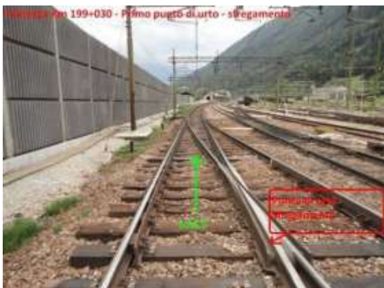
Figura 12 Fortezza segni deviatoio 25a (Foto RFI)
