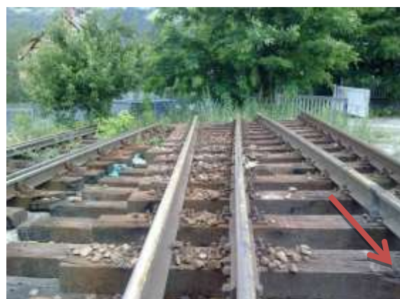
Figura 15 Segni di rotolamento (bruciatura) sui deviatoi (Foto RFI)
