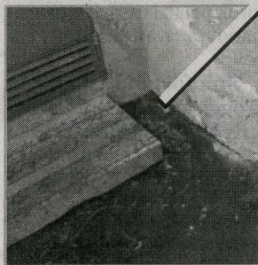
In alto centrale termica - caserma di Nicastro
